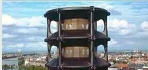
Система оповещения сигналом сирены может быть использована при крупных бедствиях и катастрофах.
